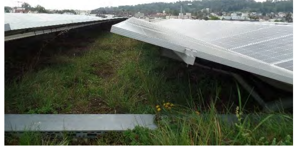
Kombinationen extensives Gründach mit PV/ Fotos Bodensee-Stiftung
